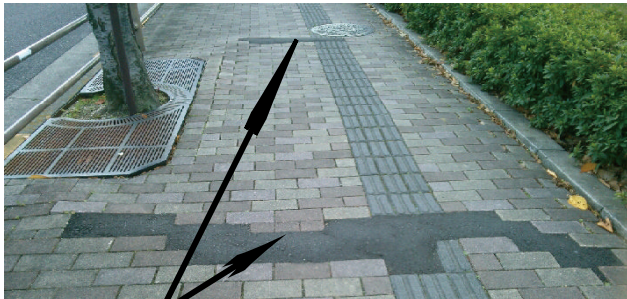
桜の根で盛り上がり、修繕された箇所
