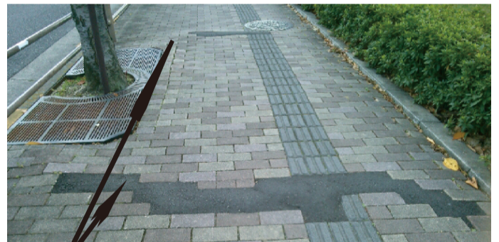
ふれ愛センター北側の「S字の町道」の歩道 桜の根で盛り上がり、補修された箇所
